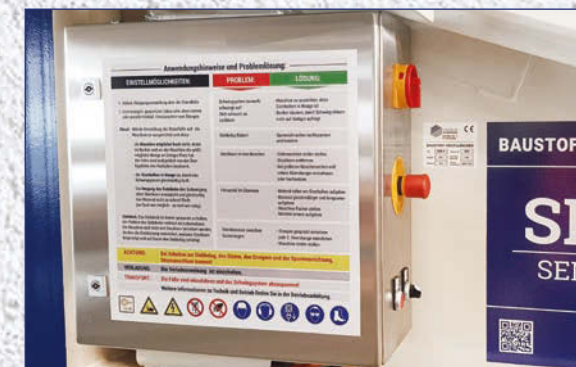
Schaltschrank mit Kurzanleitung
