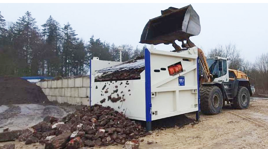
Beschickung der SBR4 mit Liebherr 576 zur Trennung des Bauschutt-Boden-Gemischs in Nützen. Foto: EAG
