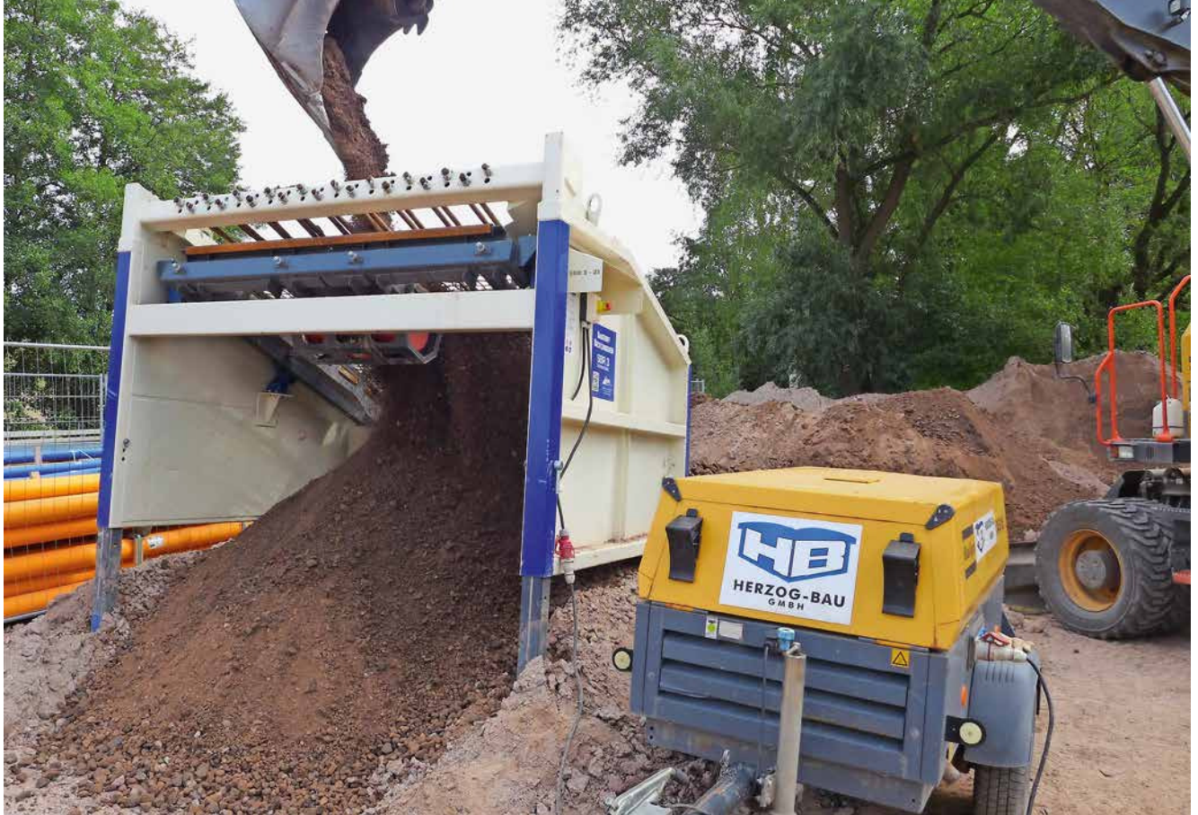
Das SBR 3 bei der Herzog-Bau GmbH
