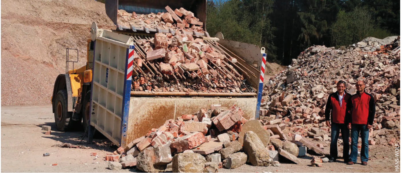
Franz Lerner – Leiter Kieswerke – und Hans-Jörg Weiß – Leiter Deponie – mit ihrer neuen SBR 2 beim Beton- und Mauerwerksrecycling in der Deponie Agendorf bei Straubing.
